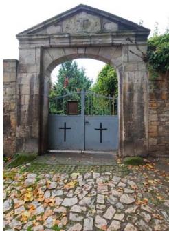
Das Portal am Friedhof ist wieder sicher.
